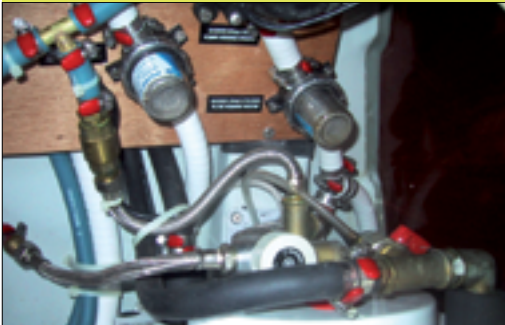
Circuito di distribuzione con annessi i filtri di depurazione dell'impianto.
