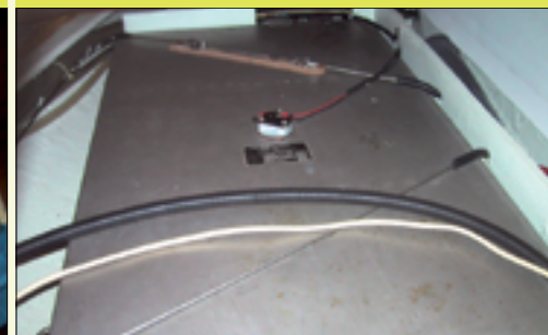
Serbatoio nafta, con cavi di tenuta e sensori; manca tuttavia un accesso al serbatoio.
