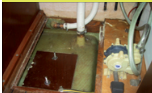
Portello di accesso a un serbatoio strutturale in vetroresina in pinna. Il coperchio ha il difetto di fessurarsi.
