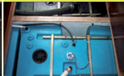
Serbatoio acqua di ultima generazione, analogo al precedente.
