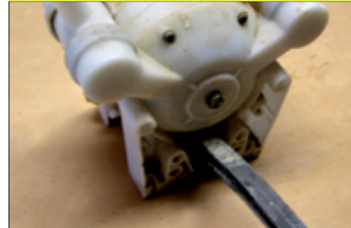
La pompa a pedale viene rimossa dalla propria sede a causa di perdite sul fondo, che hanno fatto marcire la base su cui era fissata.
