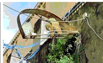
Incuria e ruggine Ciò che resta delle sagome di Dalisi ai Decumani
